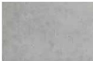
Эффект гладкого бетона
