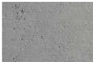
Эффект грубого бетона
